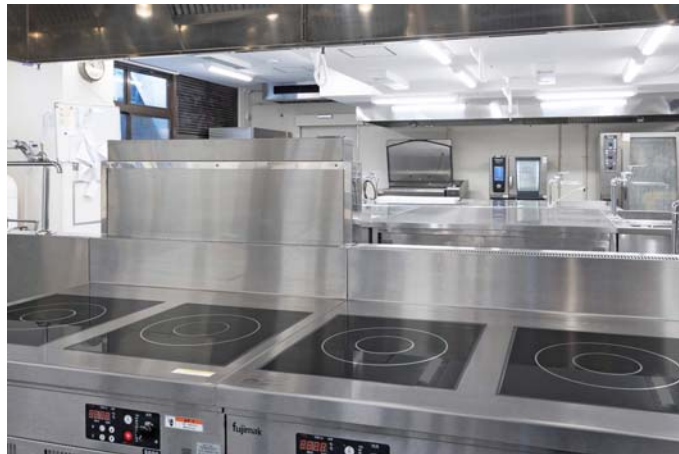
厨房環境を改善するため、ガスレンジの多くを電磁調理器と入れ替えました
