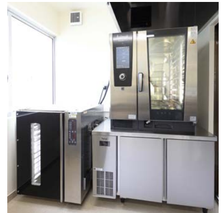
製パン室。コンビオープン、テーブル型冷凍冷蔵庫のほか、冷凍生地からスクラッチ生地まで発酵をコントロールするドウコンディショナーを導入いただいています
