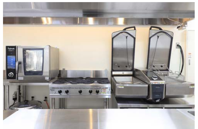
1階の主厨房。バリオデュアルパン、コンビオープン、ガスレンジなどが設置されています
